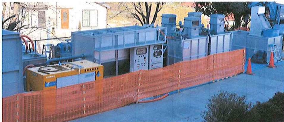
放射能汚染水浄化プラント「RPM-AP10」運転稼動時全体設置状況
